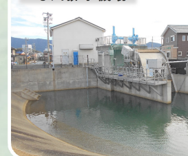
いな川排水機場
